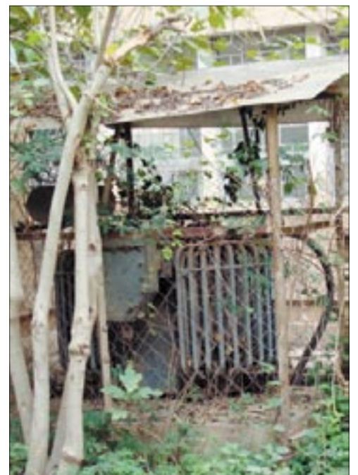
● المولد الكهربائي الذي انضجر وسبب شقوفاً
